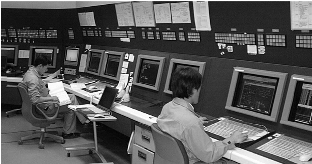
図 5.2 エチレンプラントの中央制御室
