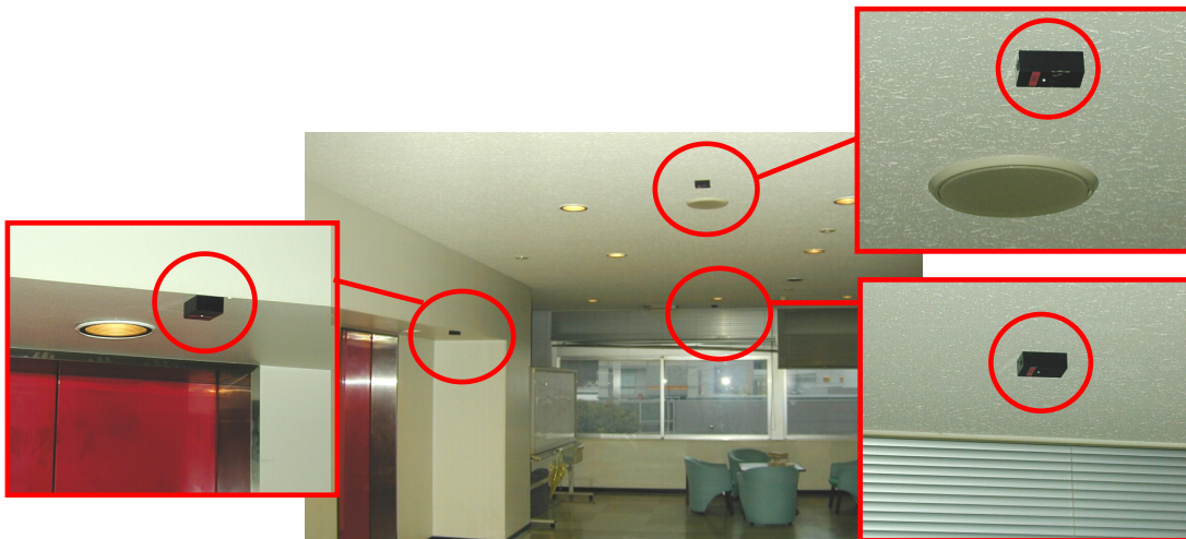
図 15 赤外線ビーコン送信機の設置例
