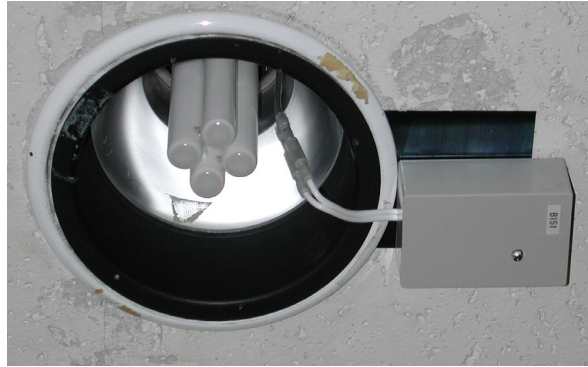
(b) 電源供給ユニットの設置例
